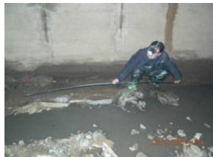
顶板拱起、破损
